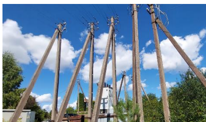
Attēls 24: Elektroapgādes infrastruktūra (apsekošana 30.07.2022.)
